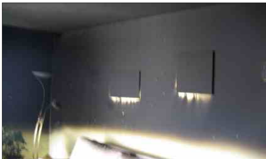
Russgeschwärzte Wand mit Bildern (in Rohr)
