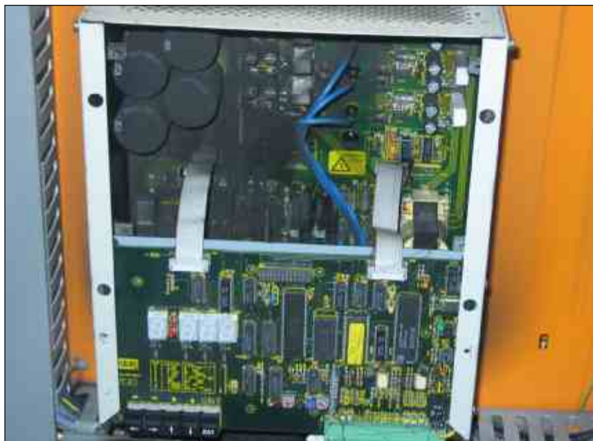
Bild vom abgebrannten E-Verteiler
